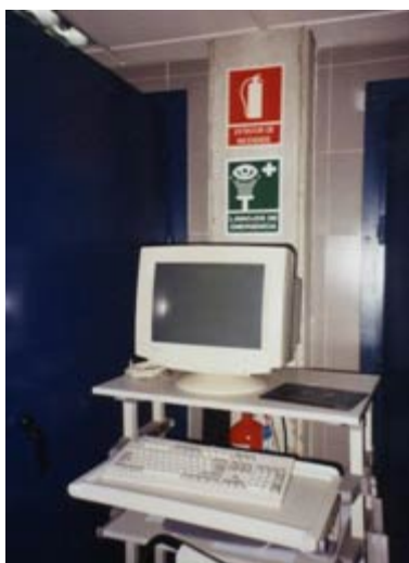
Figura 9. Extintor bloqueado por una mesa de ordenador
